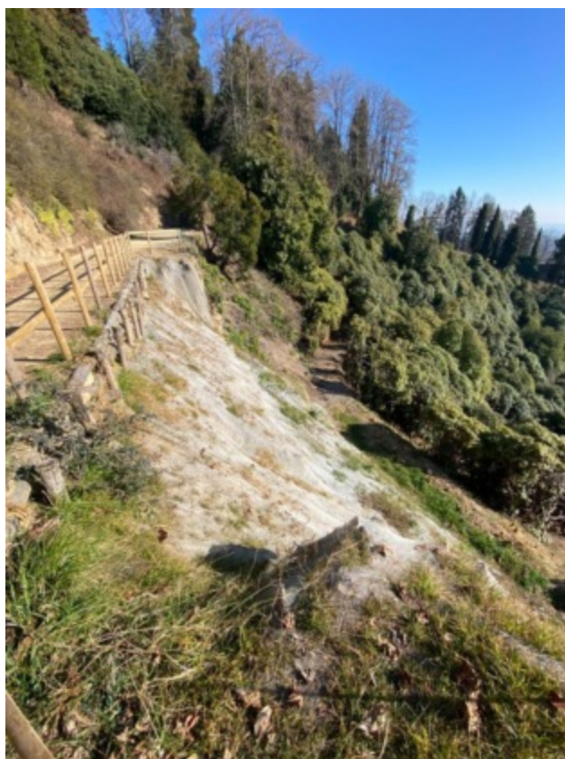
L'area tuttora "mutilata" dal collassamento del 2021.
